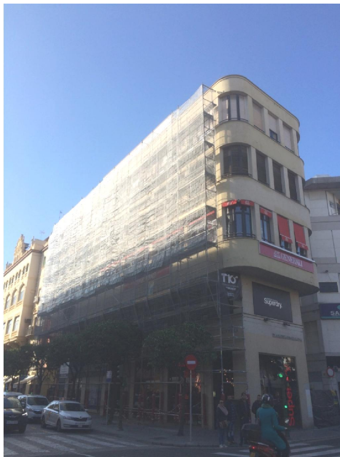
Imagen 2. Andamio instalado en el edificio Cabo Peresianas . Imagen tomada el 15 de febrero de 2018 (Fotografía: Ecouerbe).
